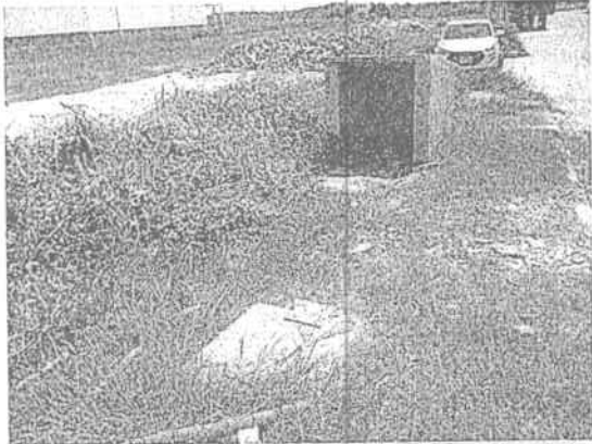
Foto 1. Área donde se encuentra la fosa séptica que recibe las aguas residuales domésticas provenientes de los baños de la empresa Steckerl Aceros S.A.S.
